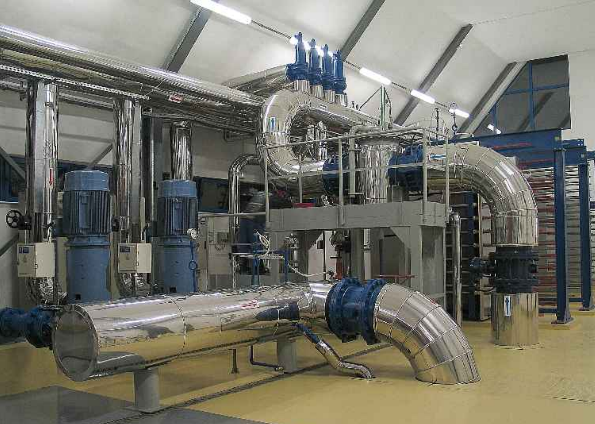
Ciepłownia Geotermalna Bańska
