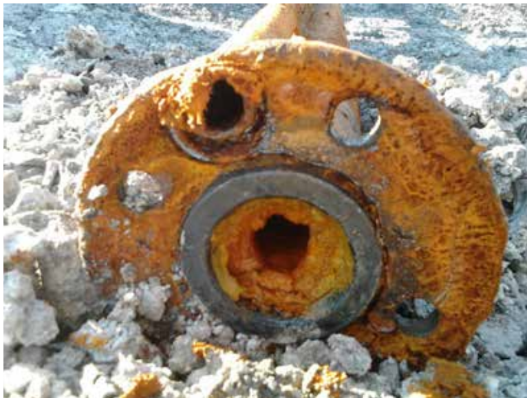
FOT. 1 Kolmatyzacja osadów na rurach tłocznych (źródło: PGE GiEK KWB Turów)
