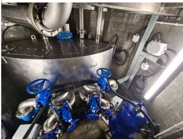
3 – rurociąg układu by-pass wraz z zasuwą serwisową 4 – zawór trójdrożny 5 – sterowanie zaworu trójdrożnego
