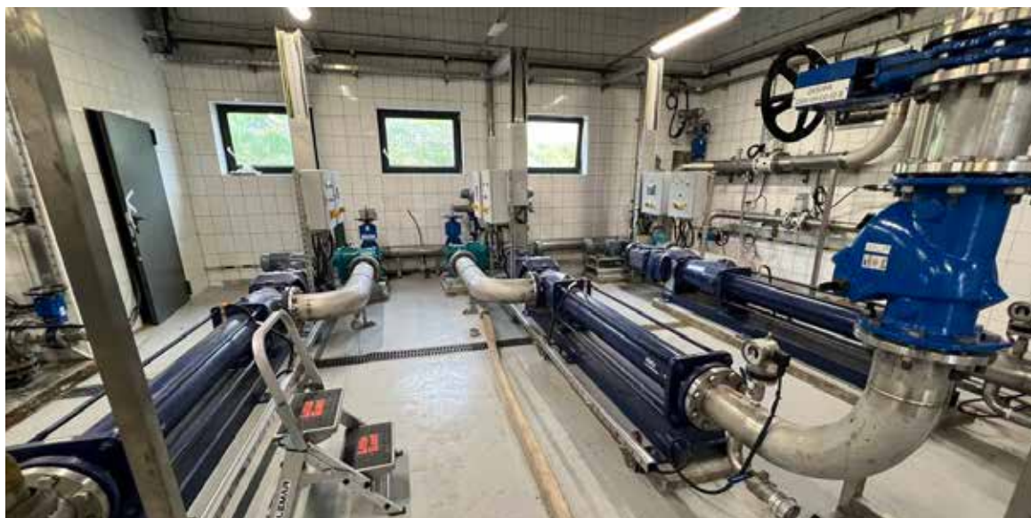
FOT. 3 Pompownia osadu zmieszanego z cz. A na cz. B
