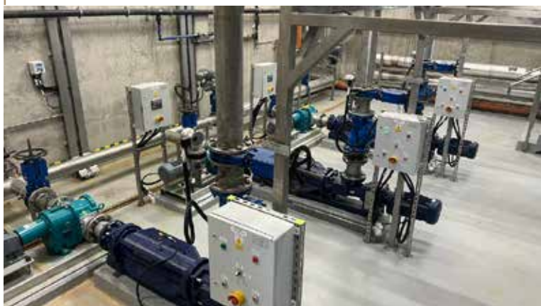
FOT. 5 Pompownia nadawcy osadu surowego WKF
