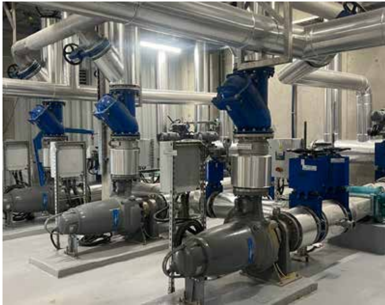
FOT. 4 Pompownia cyrkulacyjna w maszynowni wydzielonych komór fermentacyjnych
