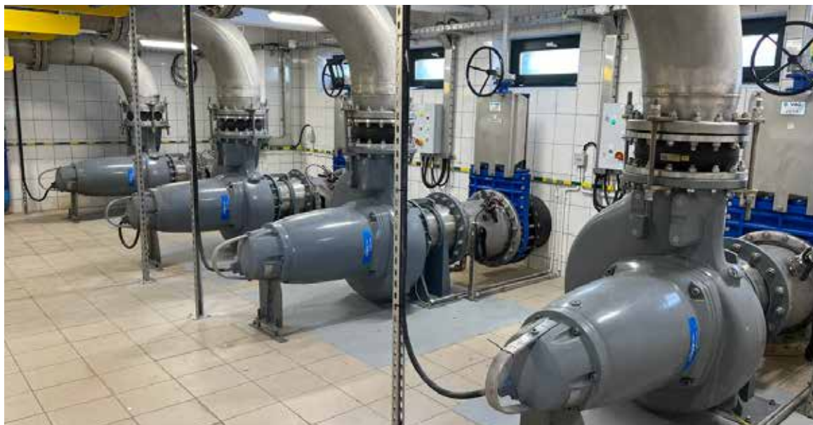
FOT. 2 Pompownia osadu recykulowanego
