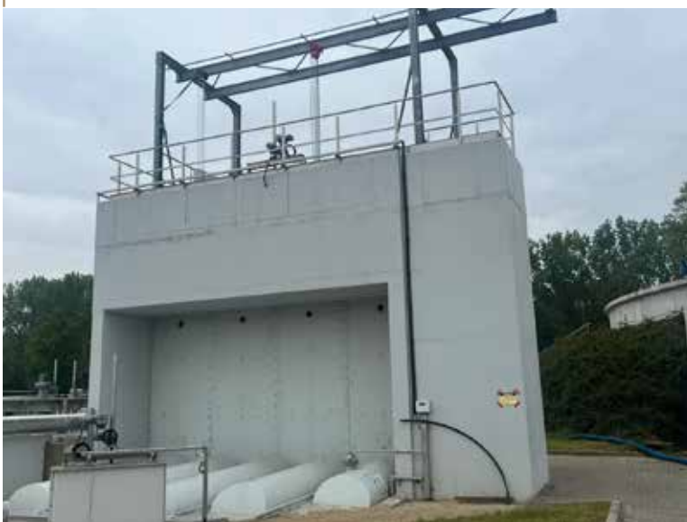
FOT. 1 Pompownia dopływu
