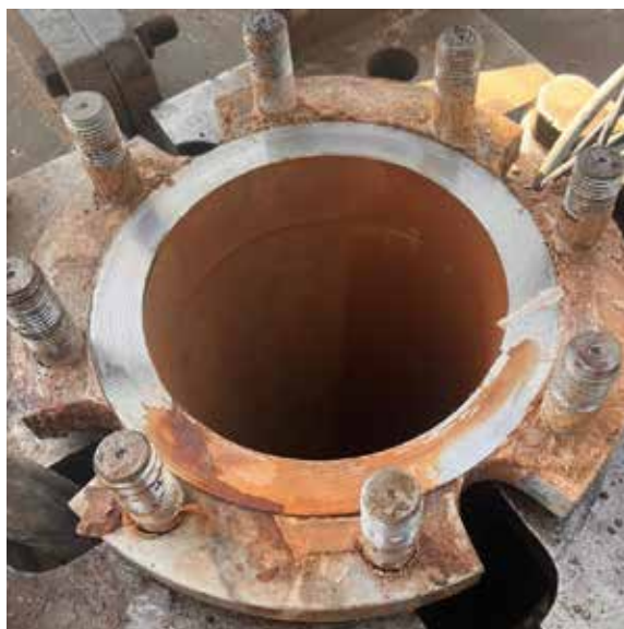
FOT. 1 Widok złącza rur z przeciekiem
