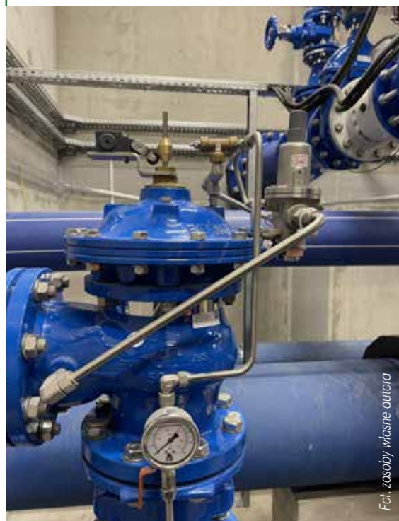
FOT. 2 Zawór przeciwdrobnociępowy-uprzedzający DN 150 mm
